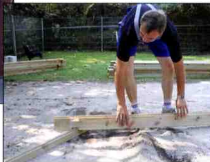
Das Aufbauteam überprüft, ob alles im Lot ist und legt anschließend die ersten Holzbohlen in Form
